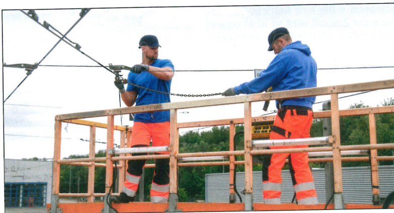
V.l.: Oliver Osten, Meister für Technik, Stromversorgung und Automaten, und Betriebselektroniker Thomas Hering begutachten den Fahrdraht der Oberleitung Fotos: maxpress
