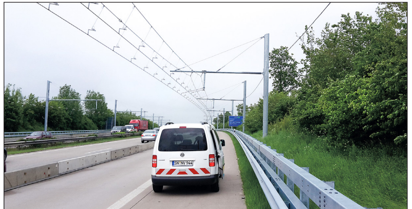
Auf der A1 wird die Energieversorgung der Lkw über Oberleitungen getestet Fotos: NVS, mp
